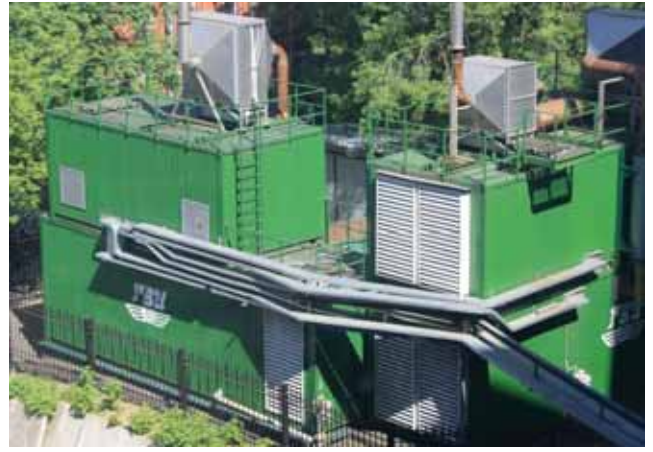
Дизельные электростанции в контейнерах вынесены за пределы основного здания
