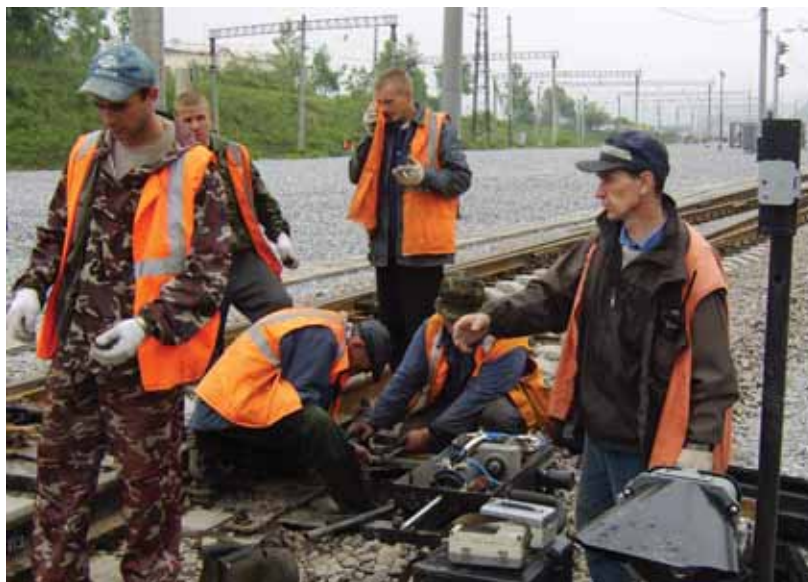
Включение новых напольных устройств на станции Ударный
