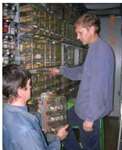
Электромеханики А.А. Родионов и А.В. Евстифеев меняют релейные блоки на посту ЭЦ станции Аткарск
